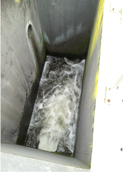
Imagem 3: água descarregada pelo decantador final: -----
